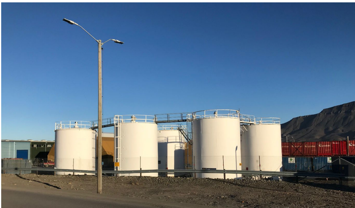
Tankanlegg for bensin i Sjøområdet, Longyearbyen. Største tank er 300 m 3
