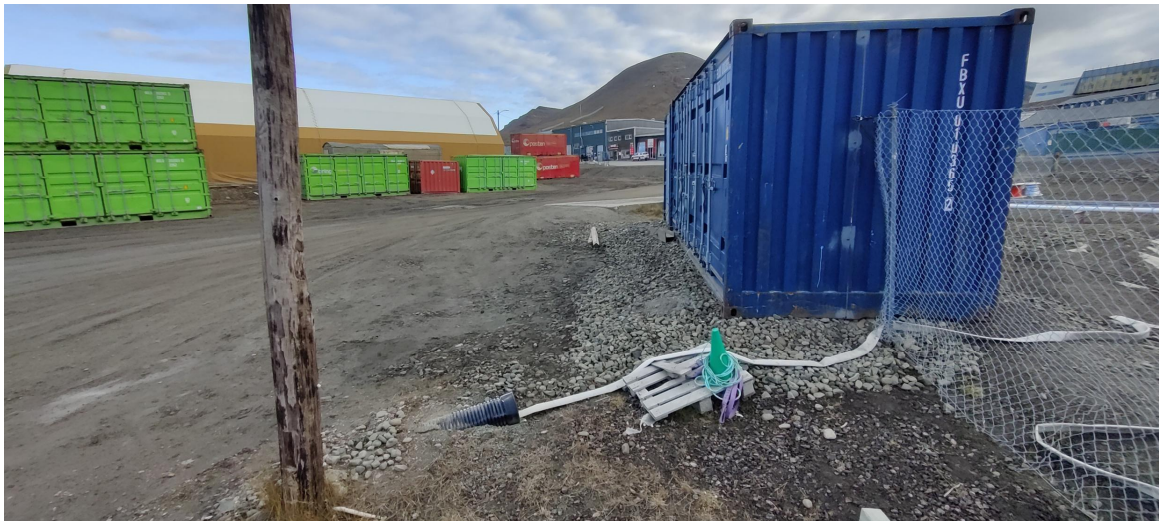
Figur 4. Avløpsrør i grunnen fra tankanlegg med slange fra pumpe. Benyttes trolig for å pumpe ut smeltevann/overvann som samler seg i oppsamlingsområdet rundt tanken.
