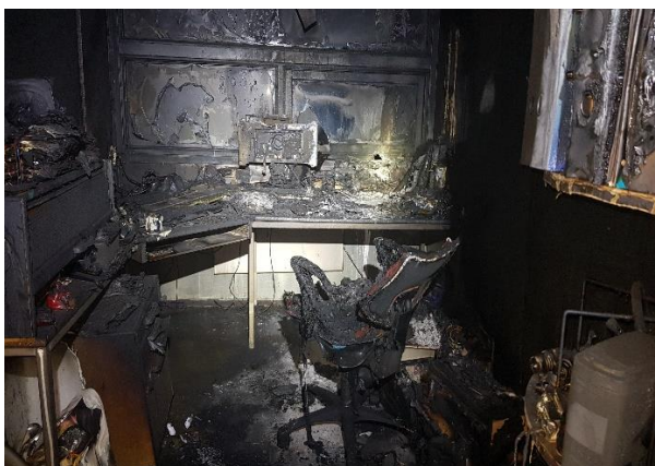
Brann i kontorbygg sjø/haustområdet, november 2020.
