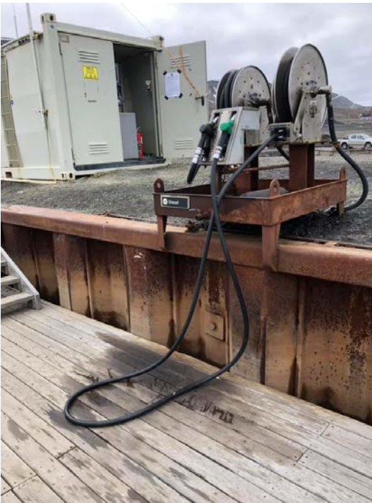
Drivstoffpumpene på brygga. Containeren med tankene vises i bakgrunnen (Foto: Totakeren)
