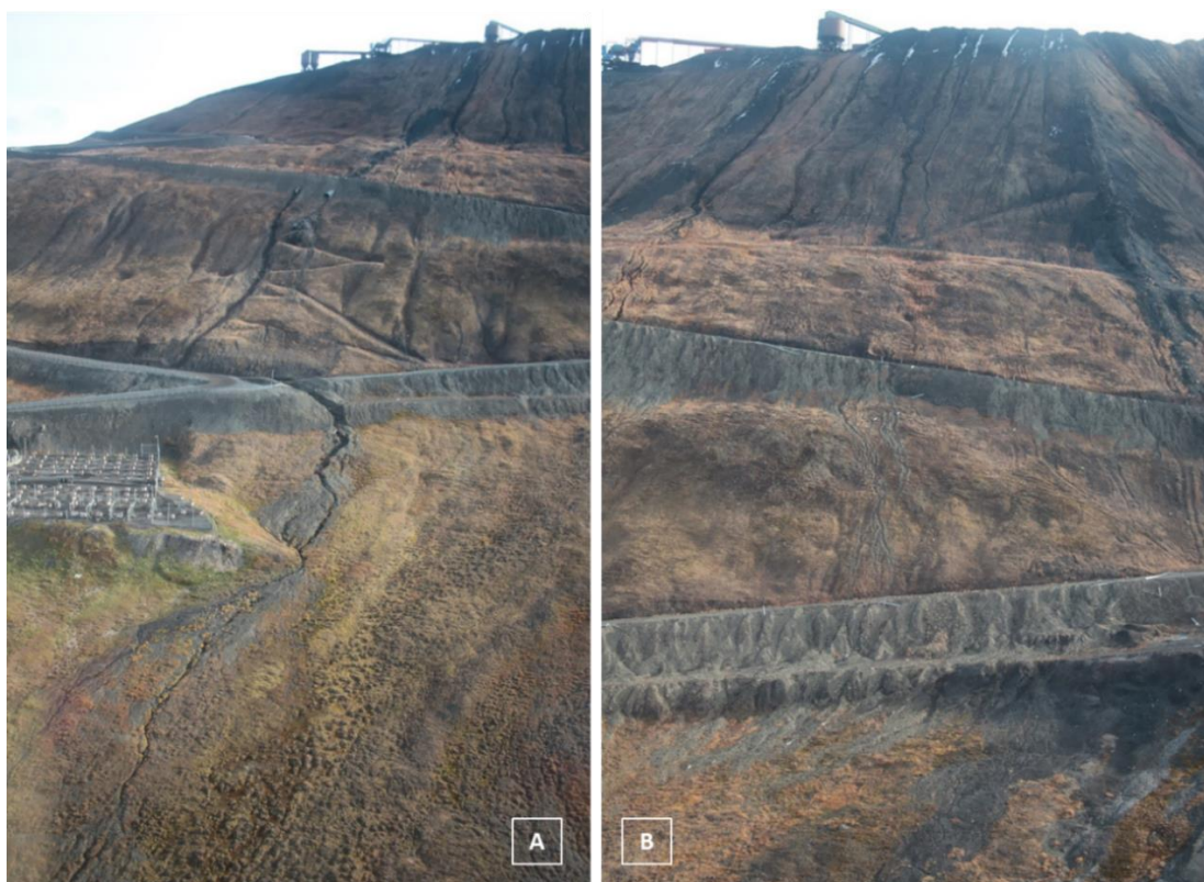
Bilde 49. Generelt i skråningen mot Gruve 7 er det økt sannsynlighet for løsmasseskred. A: Hundegården kan potensielt stå utsatt for jord- og flomskred som kan løsne fra skråningen mellom vegene. B: Det ble observert mye drenerings- og erosjonsspor i fine løsmasser i skråningen.
