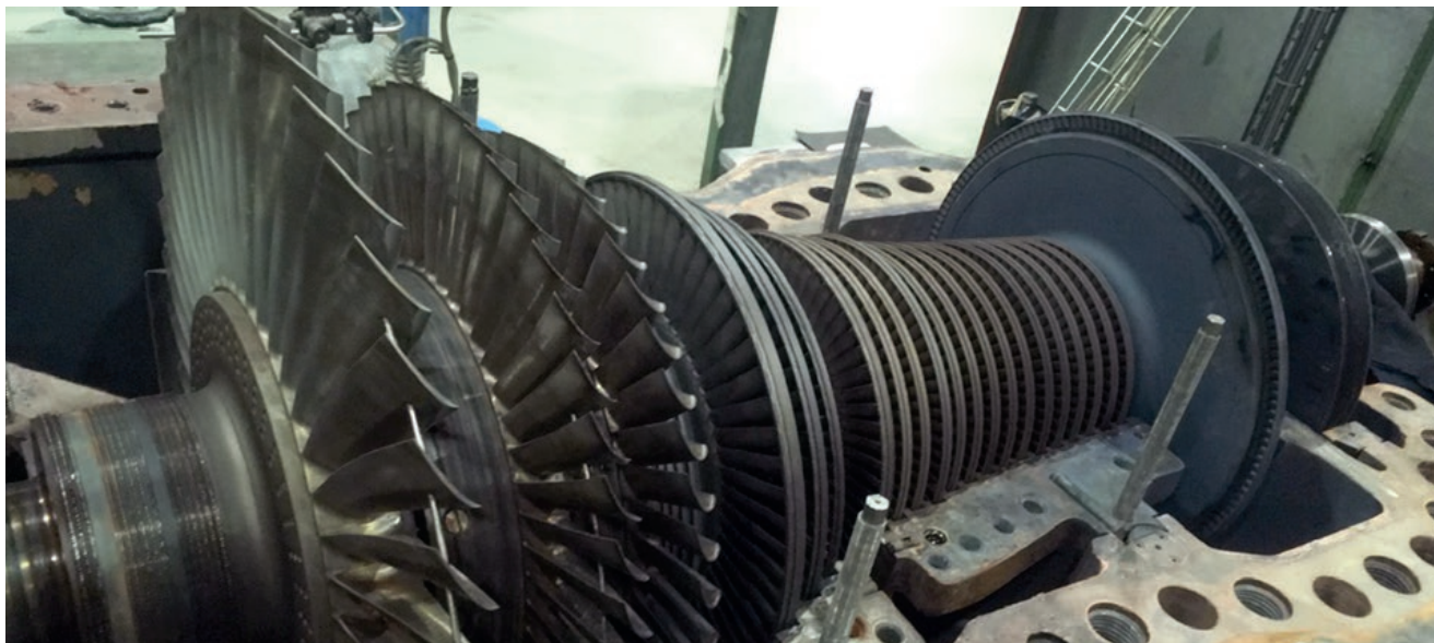
Turbin 2 ved feilsøking etter at den ble fylt med vann. Foto: Hugo Olsen
