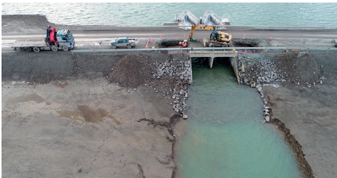
Overløp Isdammen – oppretting av lekkasje. Foto: Simon Oldani (NVE)
